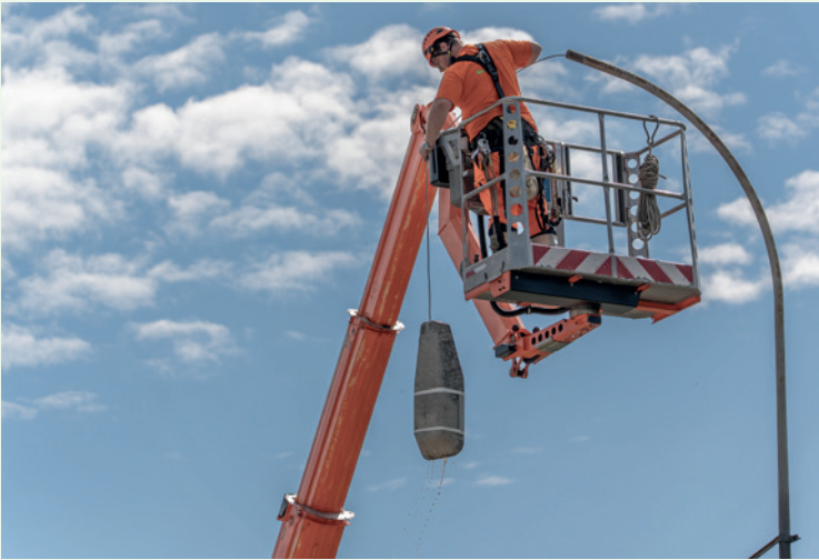
Die Natriumdampf Lampen an der Zugstrasse werden durch moderne LED-Leuchtmittel ersetzt. Durch diese Umstellung wird der Stromverbrauch verringert und die Ausleuchtung verbessert.
