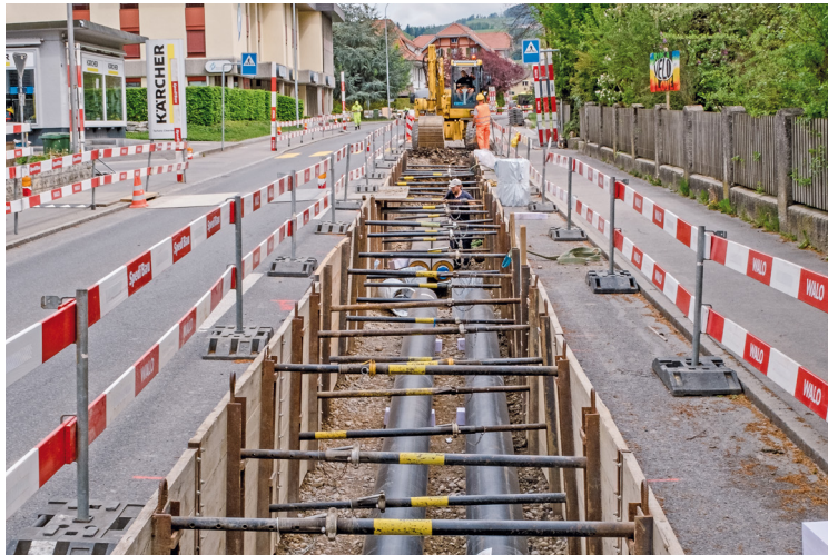
Die Fernwärmeleitung in der Ziegelei- und der Thunstrasse ist ein Schlüsselbauwerk in der Wärmeversorgung von Steffisburg Dorf.
