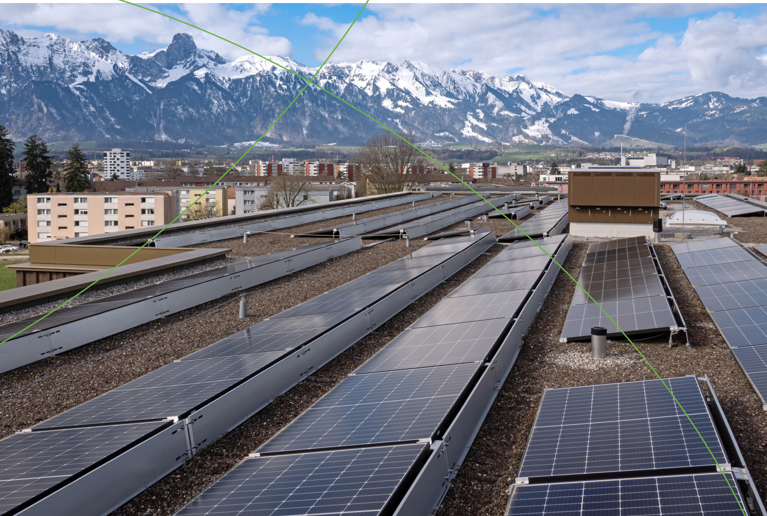
Die neueste Photovoltaikanlage der NetZulg AG auf dem Dach von Alterswohnen Glockenthal mit 60 kWp Maximalleistung.
